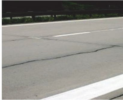
ŞEKİL 11 – GENİŞLETİLİP DOLDURULMUŞ ÇATLAK
