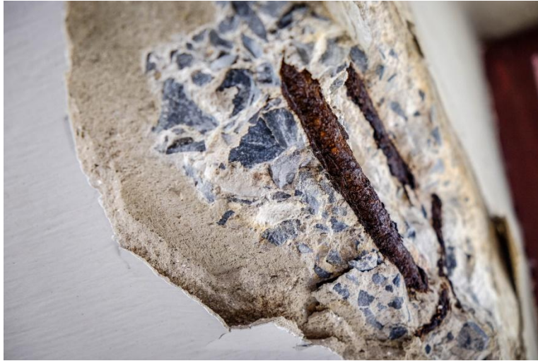
Şekil 1. Karbonatlaşma nedeniyle çelik donatıda korozyon oluşumu
