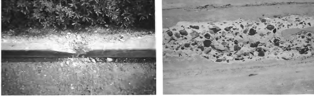
Şekil 2. Yeraltı suyunda bulunan Na ve Mg esaslı sülfat tuzlarına maruz kalan beton bordürlerde görülen yüzey bozulması (Sodyum sülfat çiçeklenmesi) [36]
