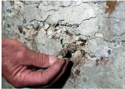
Şekil 17. Betonda pirotin kaynaklı hasar [173]
