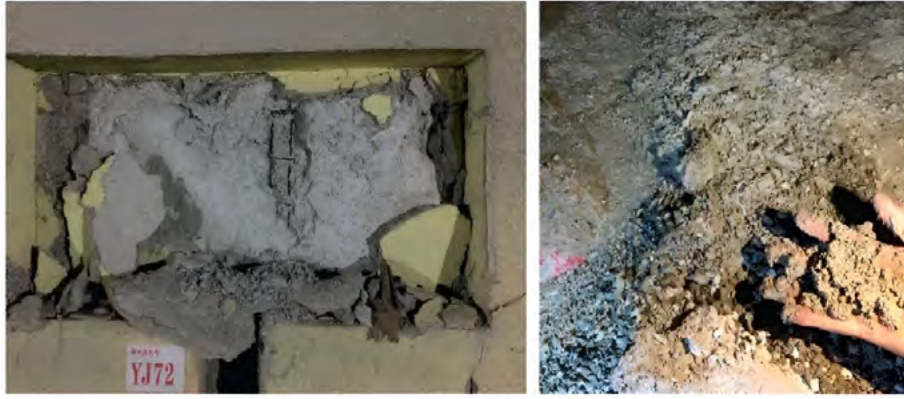
Şekil 19. Aşınmış tünel kaplama betonunun fotoğrafları [181]
