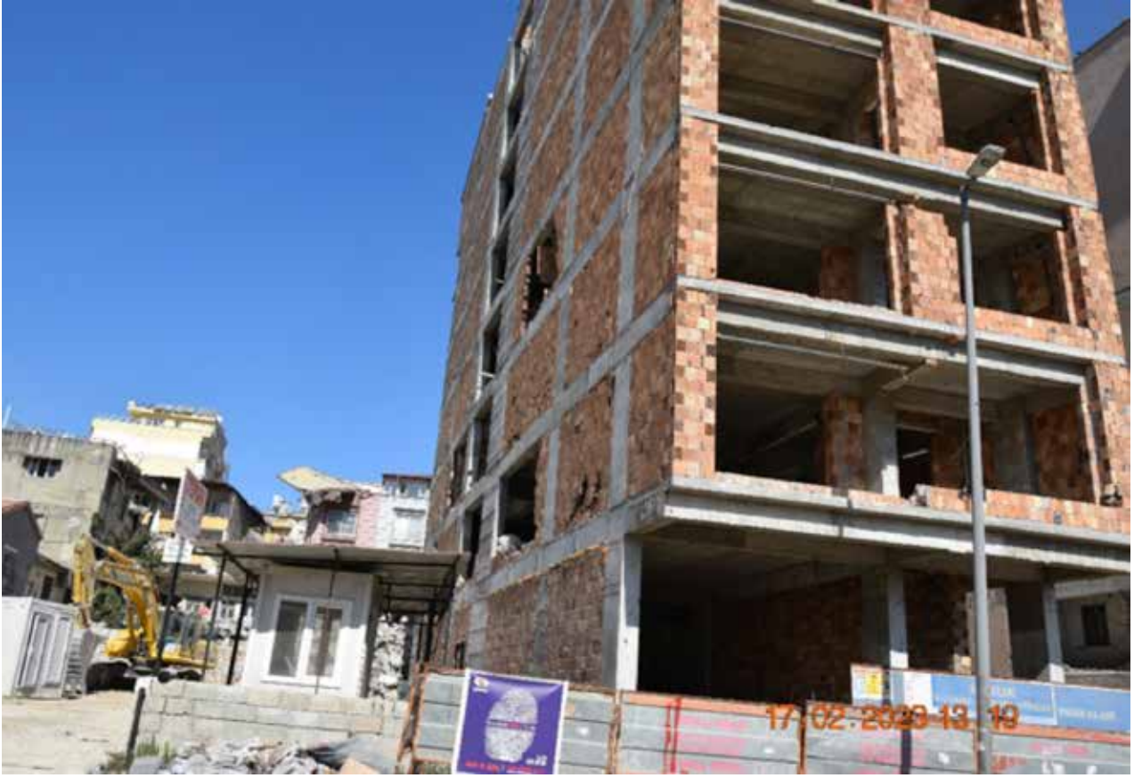
Şekil 8: Hatay'da hasar görmemiş yeni bir bina inşaatı Figure 8: An undamaged new building construction in Hatay
