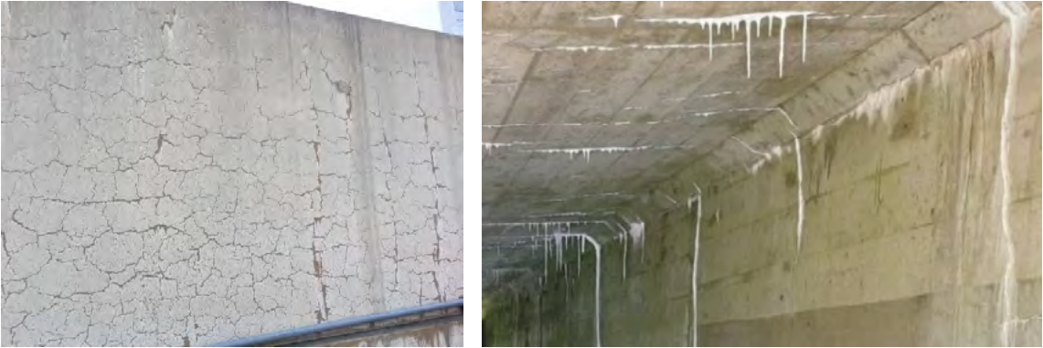
Şekil 1. ASR sonucunda yapıda oluşan hasarlar
